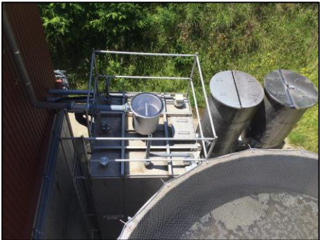
久井ファーム堆肥場雨水貯水タンク
